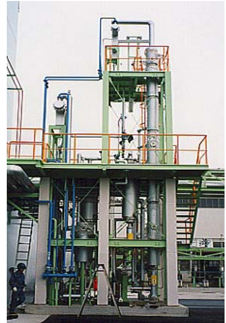
写真 溶媒回収プラント
